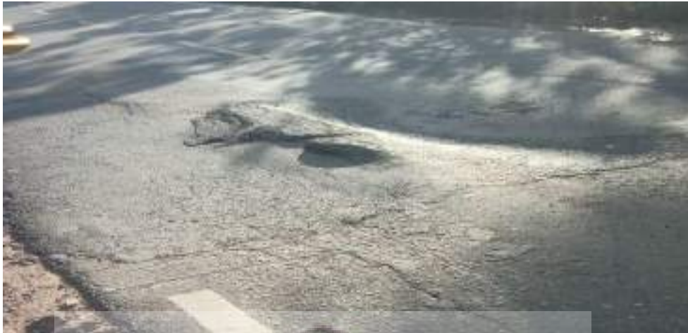
Gambar 2.7 Kerusakan Jalan Retak Memanjang Dan Melintang
