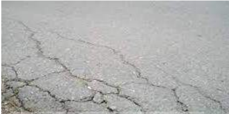
Gambar 2.5 Kerusakan Jalan Retak Sambung
