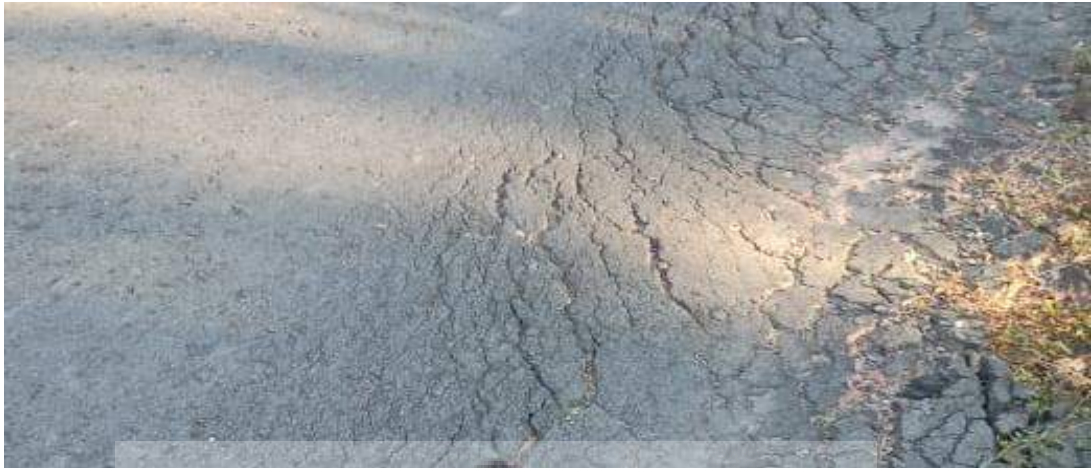
Gambar 2.1 Kerusakan Retak Kulit Buaya
